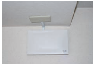
学内Wi-Fi設置
